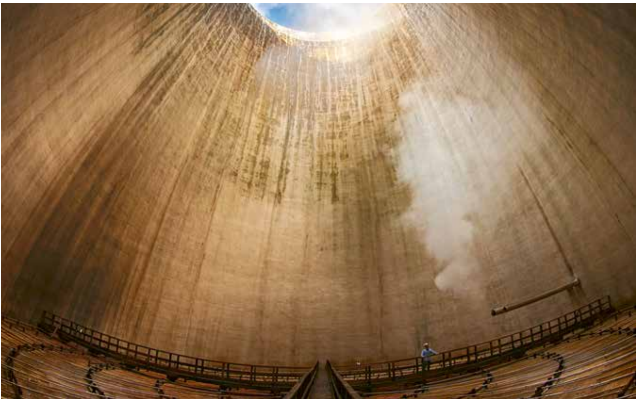
Interior de una torre de enfriamiento en Larderello. Sus dimensiones pueden apreciarse mejor al observar la figura humana en la parte inferior. Colección Fabio Sartori (Italia)
